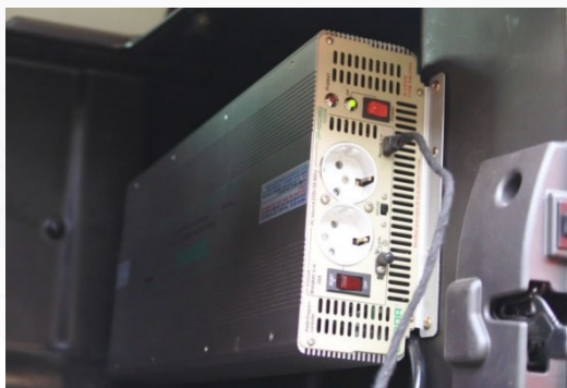
24V DC > 220V AC 전원 인버터 설치
